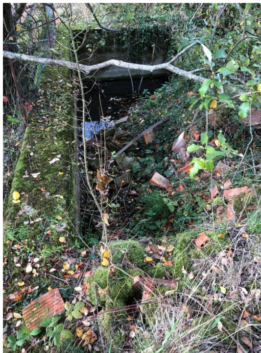
Photographie 1 : Bassin de rétention en mauvais état au Sud du site – BURGEAP 28/10/2020
